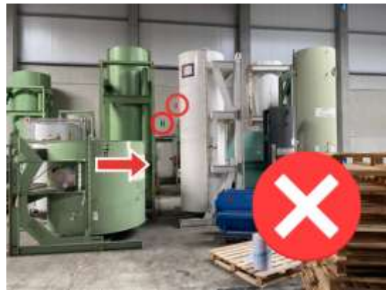
De weg naar de nooduitgang en het brandblusapparaat is versperd en de zichtbaarheid is beperkt.
